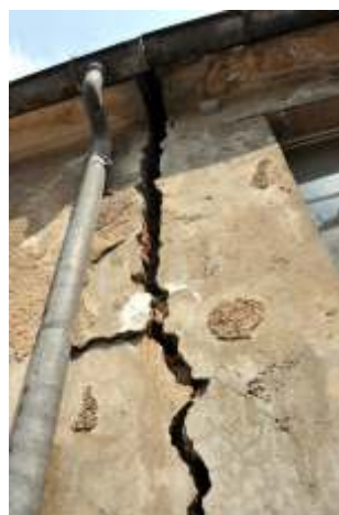
Die Altstadt von Staufen im Schwarzwald hat nach Geothermie-Bohrungen Erdverschiebungen hinnehmen müssen. Seit 2007 hebt sie sich im Schnitt um einen Zentimeter pro Monat.
